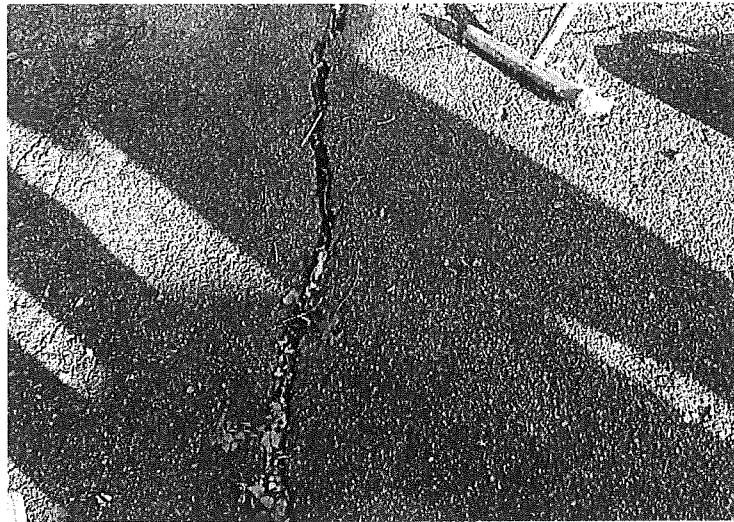
Рис.8. Тріщини в асфальтобетонному покритті обвалування
