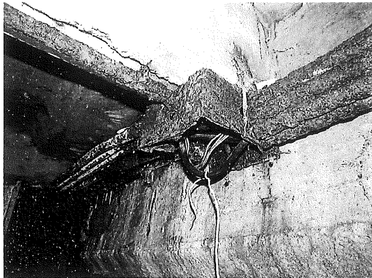
Рис.10. Загальний вигляд стану електромережі
