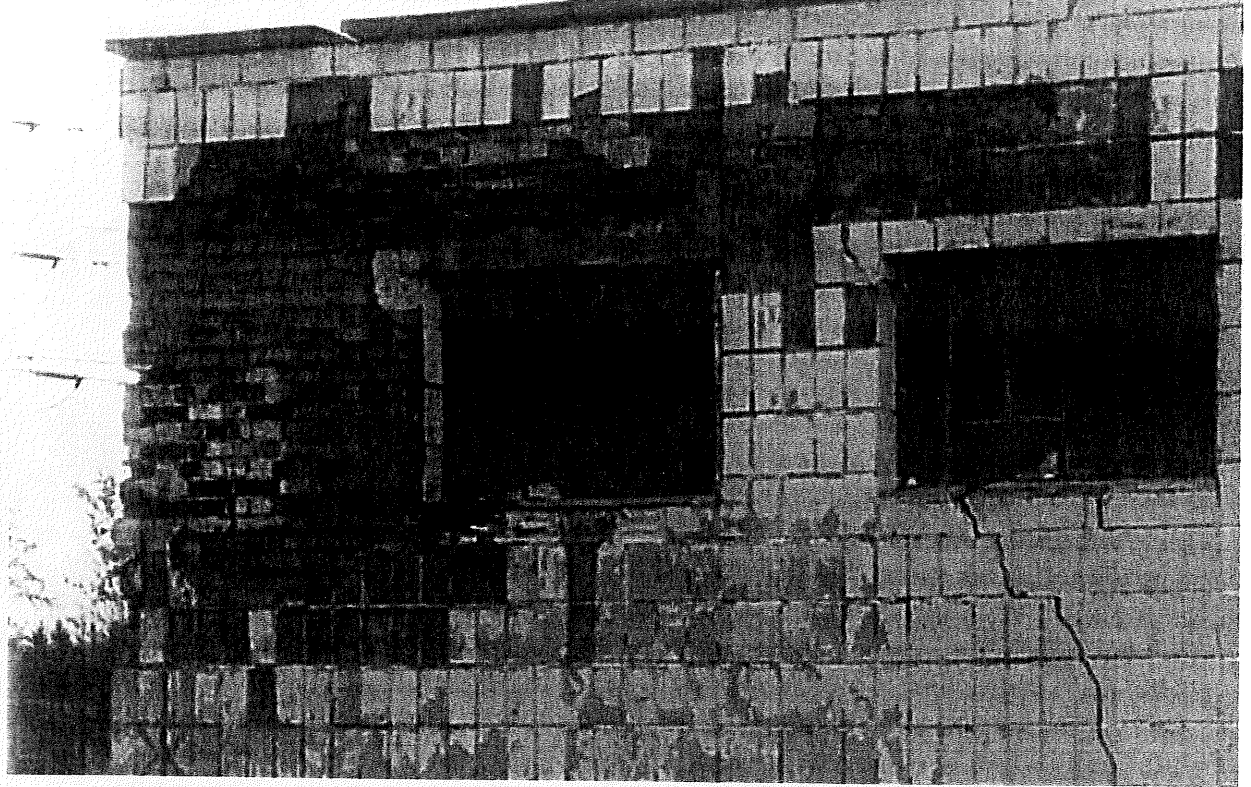
Фотографія 3. Руйнування облицювання, кам'яної кладки головного фасаду, швів парпетних плит, наскрізні тріщини, деструкція цегли та швів.
