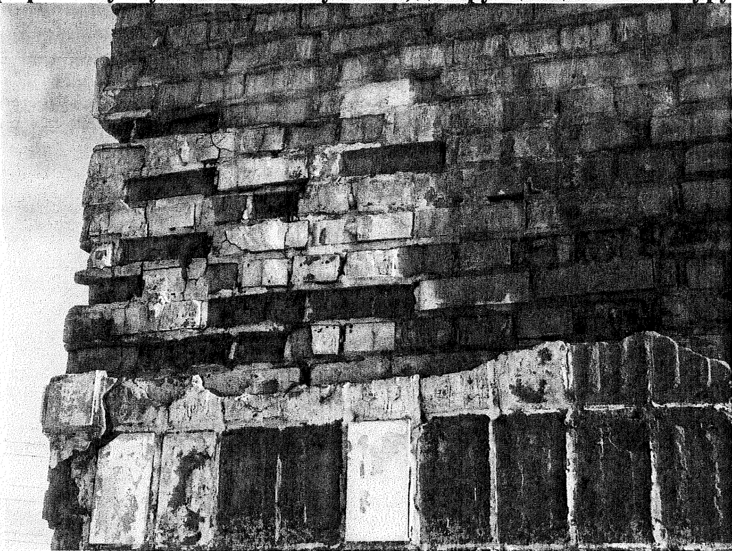
Фотографія 6. Руйнування облицювання, деструкція цегляного мурування.
